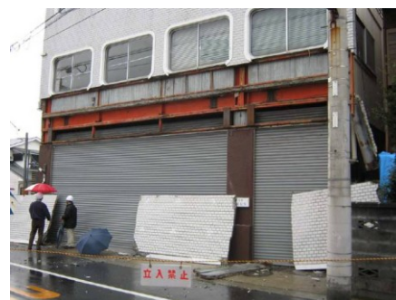
外壁落下の状況例 ※3 （富士市 HP）
