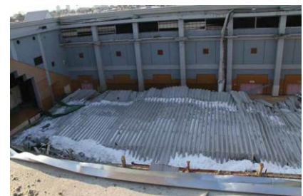
図表 7 体育館屋根の崩落状況
